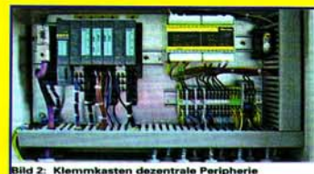
Bild 2: Klemmkasten dezentrale Peripherie
